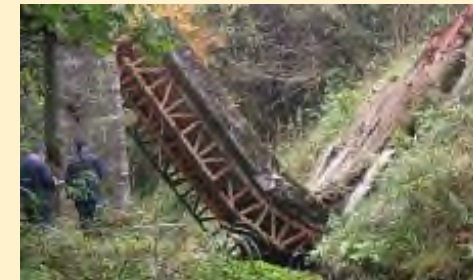
香川・徳島県境無名橋の落橋 (2007年)
