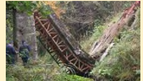
香川・徳島県境無名橋の落橋 (2007年)
