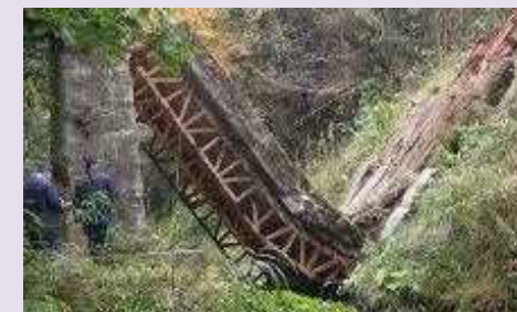
香川・徳島県境無名橋の落橋 (2007年)
