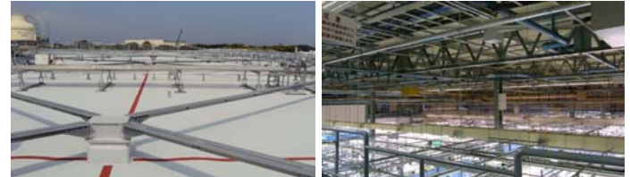
工事完了後の補強ブレース全景 配管・ダクトで覆われた工場内部
